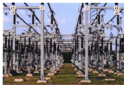
Umspannwerke passen die Spannung von Strom an Transport- und Verteilnetze an und bilden zentrale Knotenpunkte der Energieinfrastruktur
